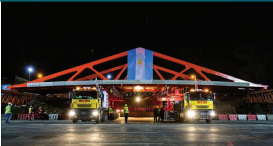
ALE Lift estuvo a cargo del montaje y desmontaje de varios puentes sobre Av. General Paz, en Buenos Aires.
