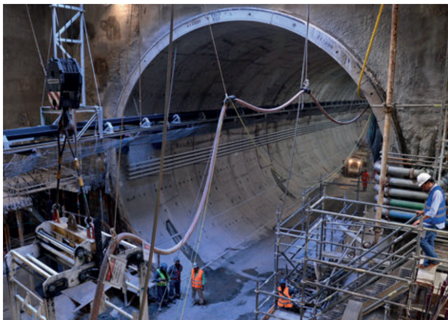
Las obras de la línea 4 del metro de Río de Janeiro casi paralizaron, pero un aporte federal de urgencia garantizó su terminación para los Juegos Olímpicos.
