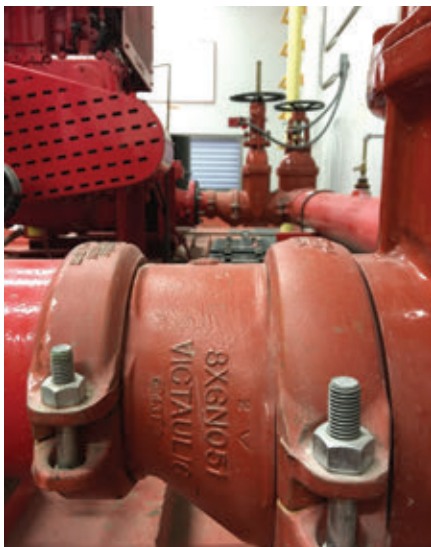
Ejemplo de acople apernado y sellado utilizado en el cuarto de bombas del aeropuerto El Dorado.
