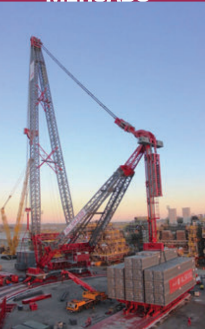
El equipo está en Brasil, donde ayuda con la construcción de un buque plataforma.
